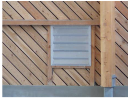
ventilation basse dans la salle
