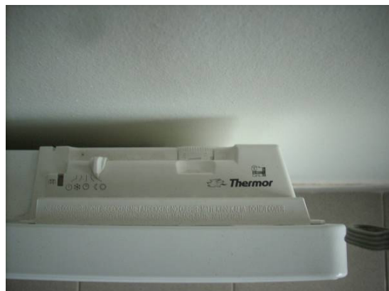
Réglage des convecteurs Localisation : dans tout le bâtiment à l'exception de la salle de sport
