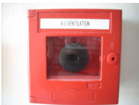
Arrêt d'urgence ventilation
