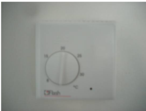
Thermostat central pour le hall des vestiaires Localisation : à côté du bureau
